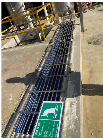
图 3-4e 废水处理站排放口
