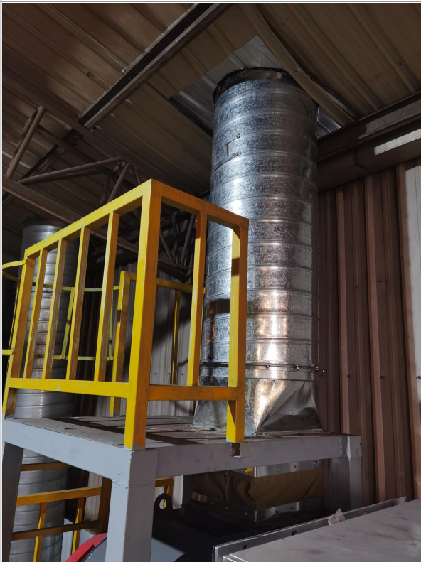
废气排放口 FQ-19192
