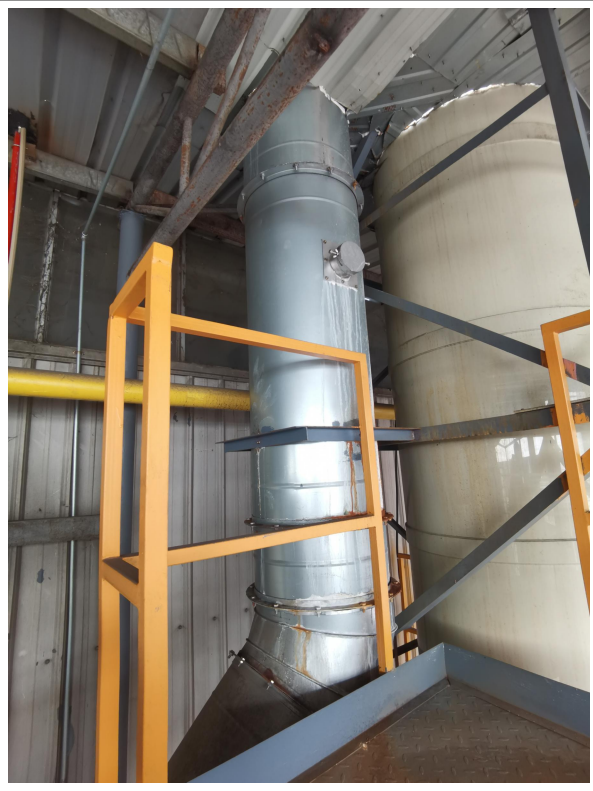
废气排放口 FQ-19195
