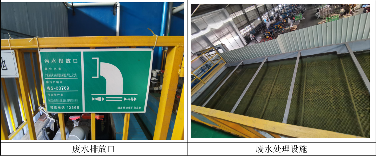
图 5-2 生产废水处理设施
