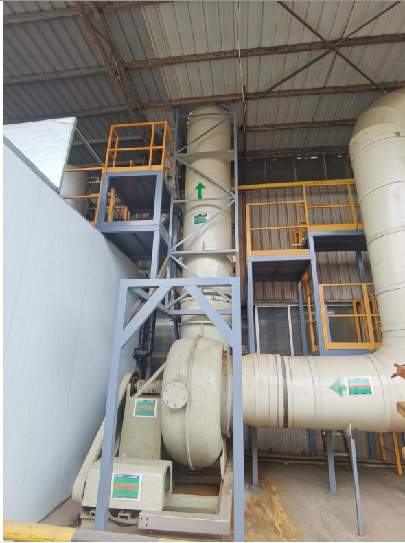
废气排放口 FQ-19194
