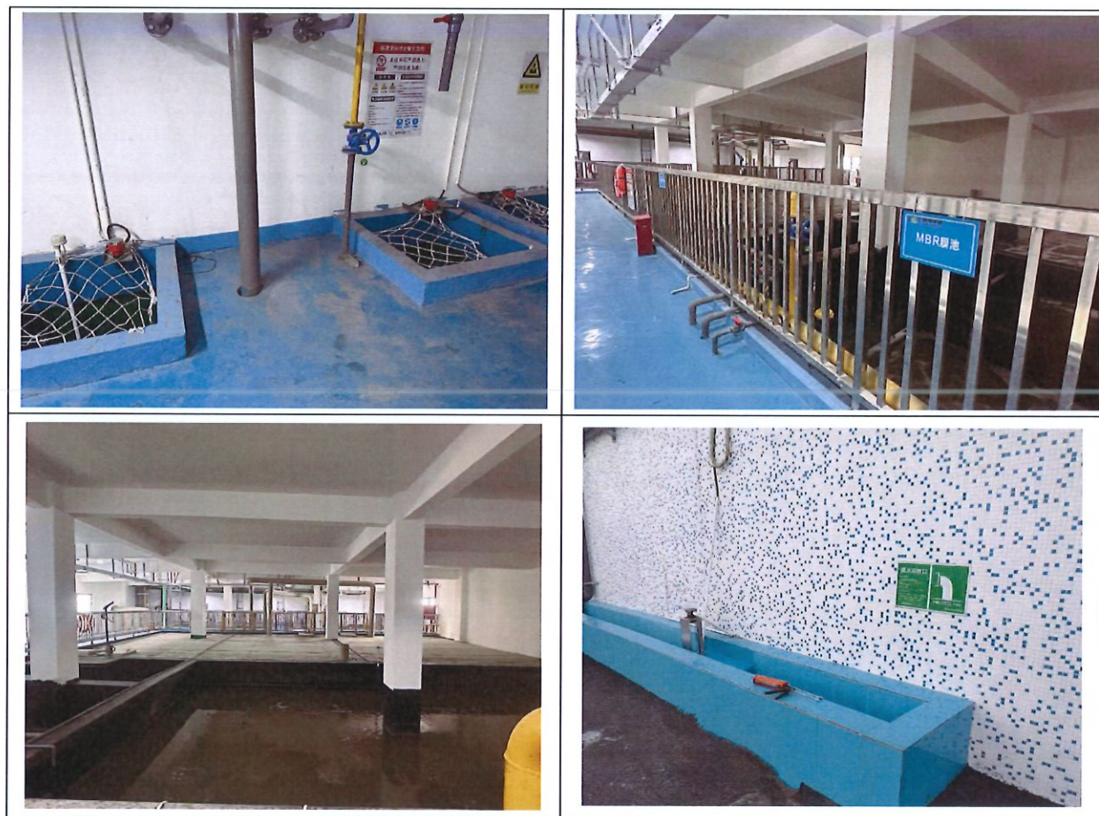
图 5-1 广东海协实业有限公司废水处理站
