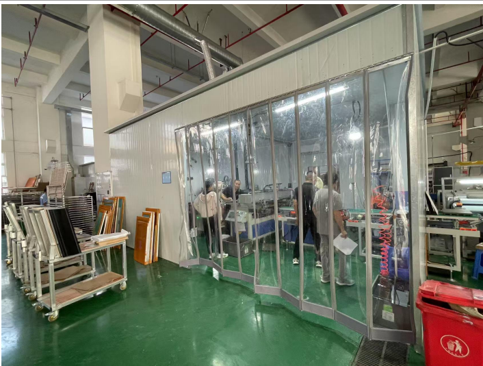
图 3-4e 废气收集措施
