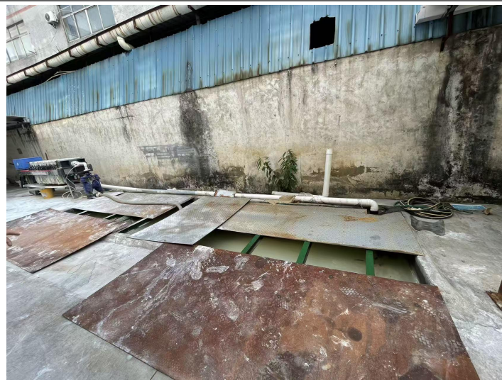
图 3-4h 废水处理设施
