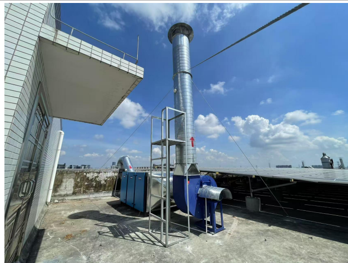
图 3-4f 废气处理装置与排气筒
